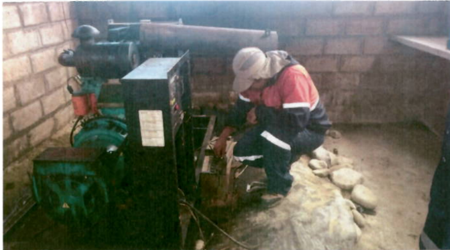
Ing. 1 revisión del generador eléctrico del campamento
