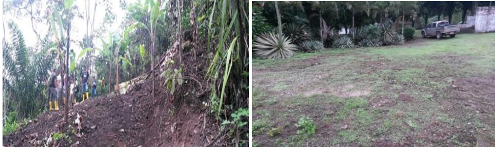
Fotografías Nro. 24 y 25. Rehabilitación de las plataforma de perforación TOR01 y TOR02
